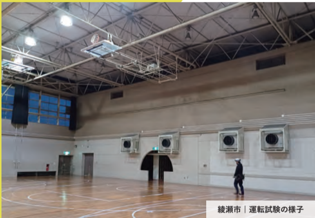
綾瀬市 | 運転試験の様子
