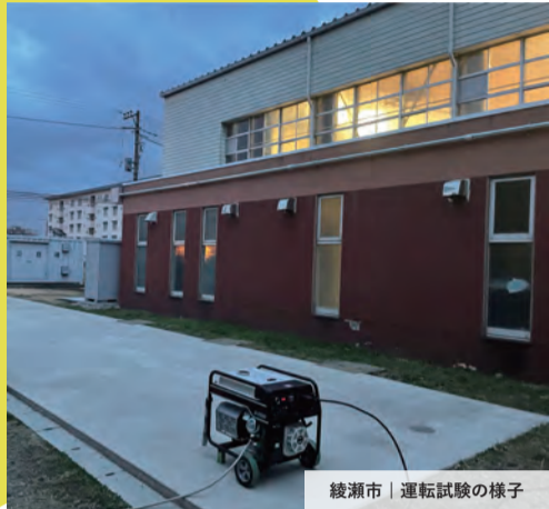
綾瀬市 | 運転試験の様子
