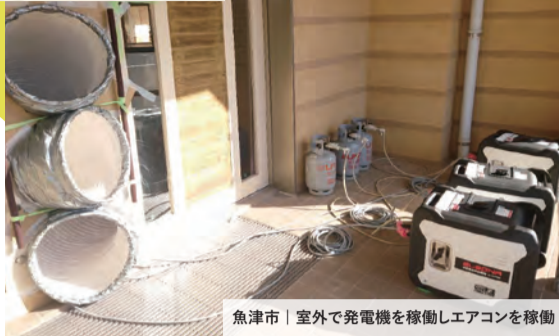
魚津市 | 室外で発電機を稼働しエアコンを稼働
